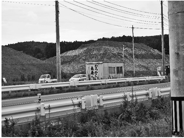
写真3 嵩上げ工事が進む中、「なつかしい未来へ」と書かれたプレハブが建つ南三陸町（2016年筆者撮影）
